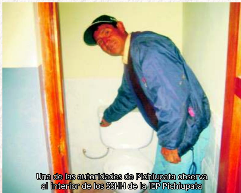
Autoridades de la comunidad de Pichiupata posan en el módulo de los SSHH de la IEP Pichiupata concluidas.
